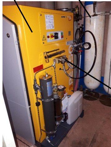
Rampe de gonflage
